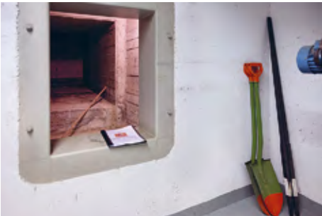
Väestönsuojissa on hätäpoistumiskäytävä ja välineet sen avaamiseksi.
